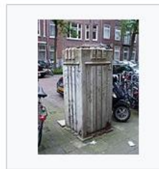
Elektrische verdeelkast (splitskast) Gemeente- Electriciteitswerken
